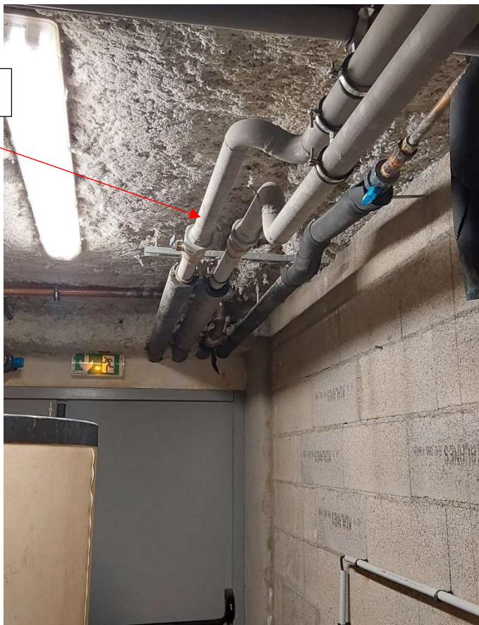
Nappe de tube en chaufferie
