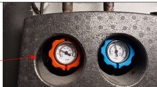
Température départ/retour solaire 42°C et 40°C
