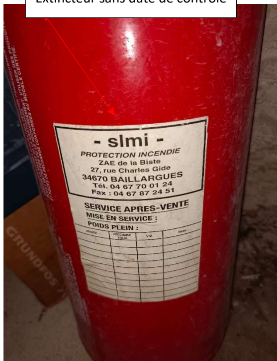
Extincteur sans date de contrôle
