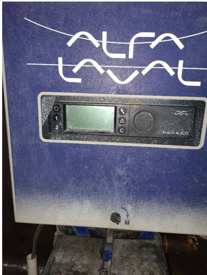
Echangeur à plaque production d'eau chaude
