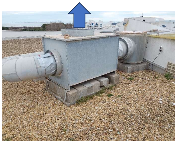
Débit 6 285 m 3 /h
